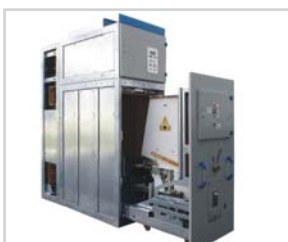
Выкатные устройства в шкафах и сборках.
